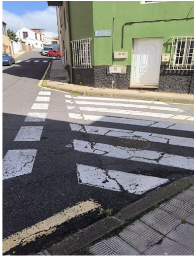
Barrio Nuevo. Acera sin rebajes en paso de peatones. Calle Juan Pérez Delgado.
