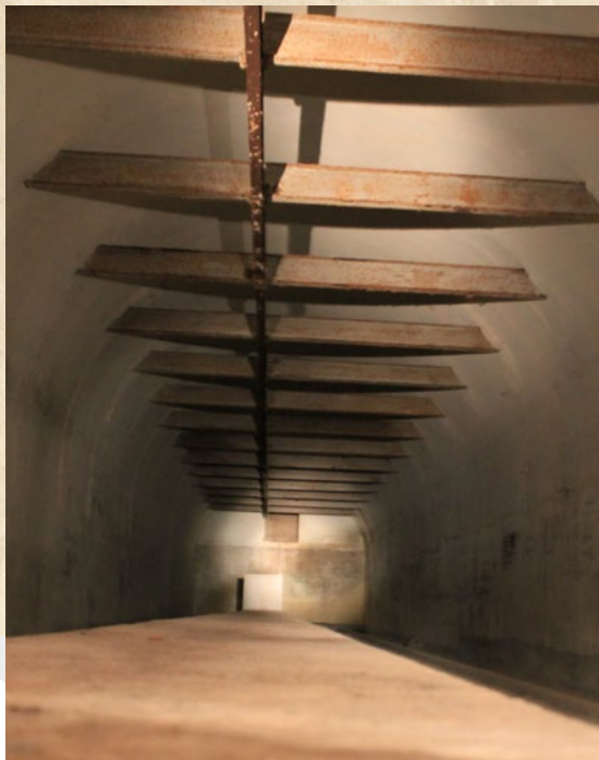
Interior de las instalaciones. Foto: Tomás Rodríguez
